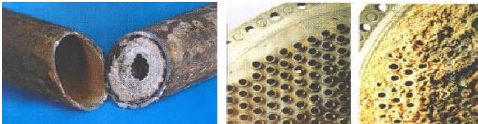
Рис. 6, 7, 8. Состояние труб системы отопления и теплообменников до и после «мягкой» очистки.
